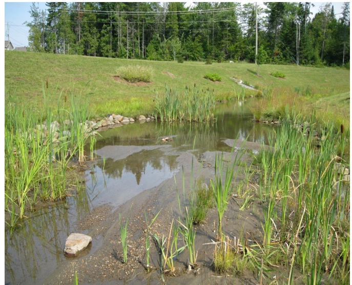
Figure 11. Surplus de sédiments à l'entrée du bassin
